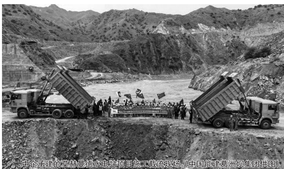
中企承建的莫赫曼德水电站项目施工截流现场。(中国能建葛洲坝集团供图)
